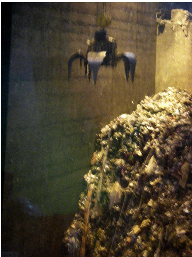
FIGURE 33 – La fosse à déchets alimentant l'incinérateur de Vert-le-Grand.
